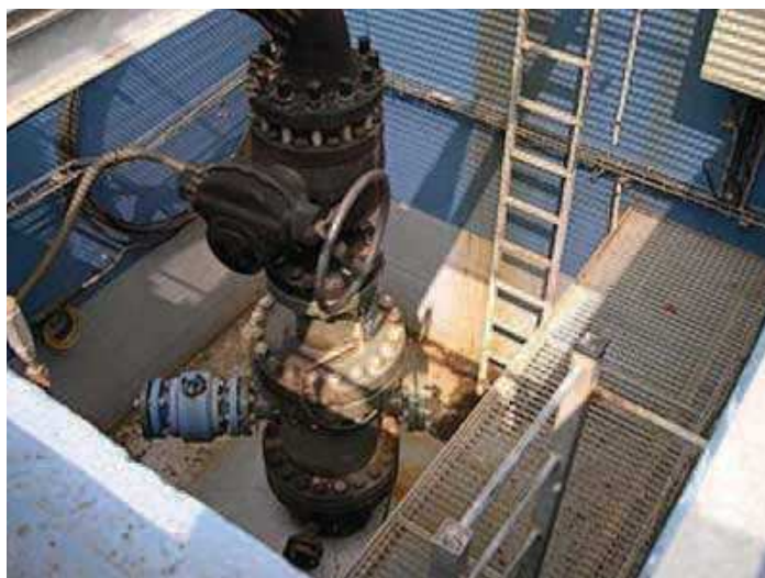
© Arene Ile-de-France - Tête de puits sur le site géothermique de Chevilly-Larue / L'Haÿ-les-Roses (94).
