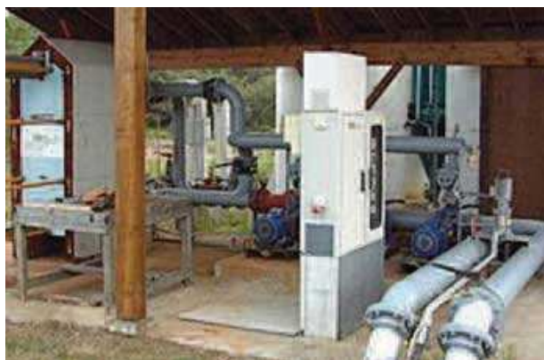
© BRGM - Installation géothermique pour le chauffage de la pisciculture de Mios le Teich (Gironde) à partir d'anciens forages pétroliers
