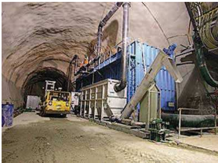
© AlpTransit Gotthard AG - Caverne longitudinale avec dessableur et bassin de stockage pour l'eau souterraine drainée par le tunnel du Gotthard en Suisse.
