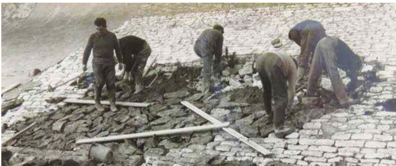
Travaux sur la digue du Boutillon après la tempête de janvier 1966, photographie, Archives départementales de la Charente-Maritime, série W, Cliché de la Communauté de communes de l'Île de Ré
